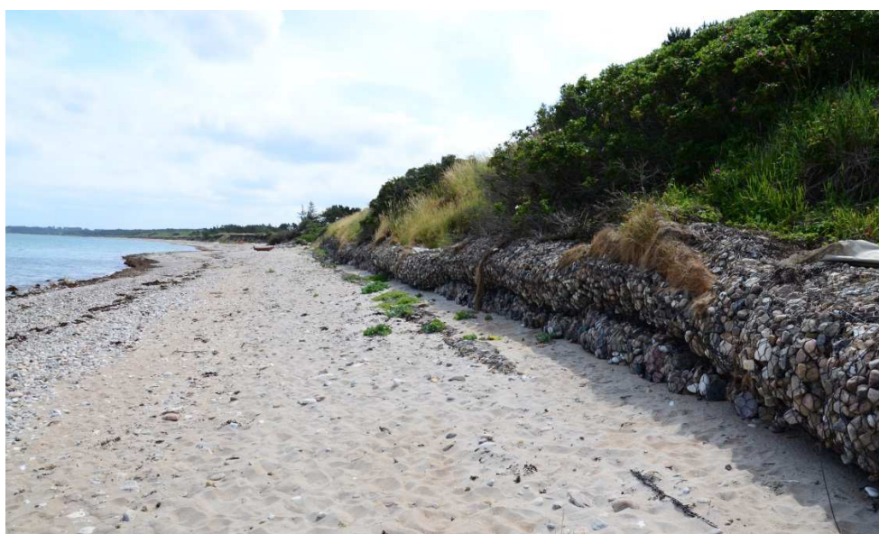
Figur 6-16 Gabion-muren ved Nordre Strandvej bør forstærkes med dæksten og filtersten
