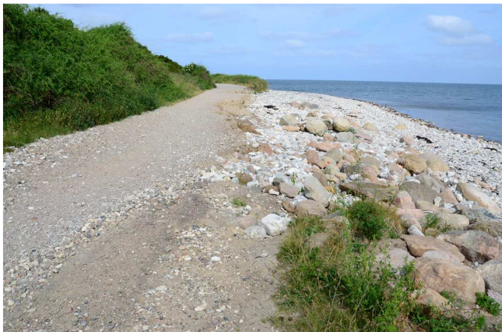
Figur 2-11 Stenstrand og eroderet vej nord for Klint Havn og nord for Østergårdsvej
