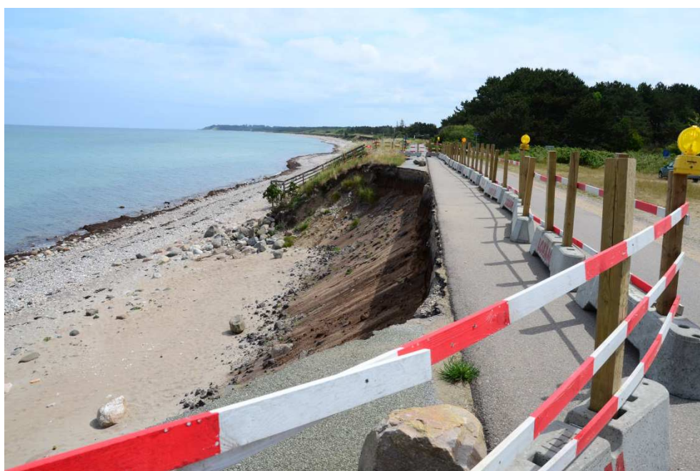
Figur 2-21 Ødelagt gabion-mur og erosion af skrænten ved Nordre Strandvej ved Lumsås
