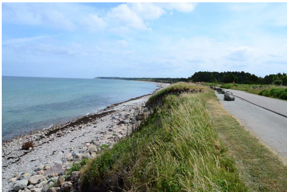
Figur 2-24 Ødelagt skræntfodsbeskyttelse og erosion af skrænten ved Nordre Strandvej
