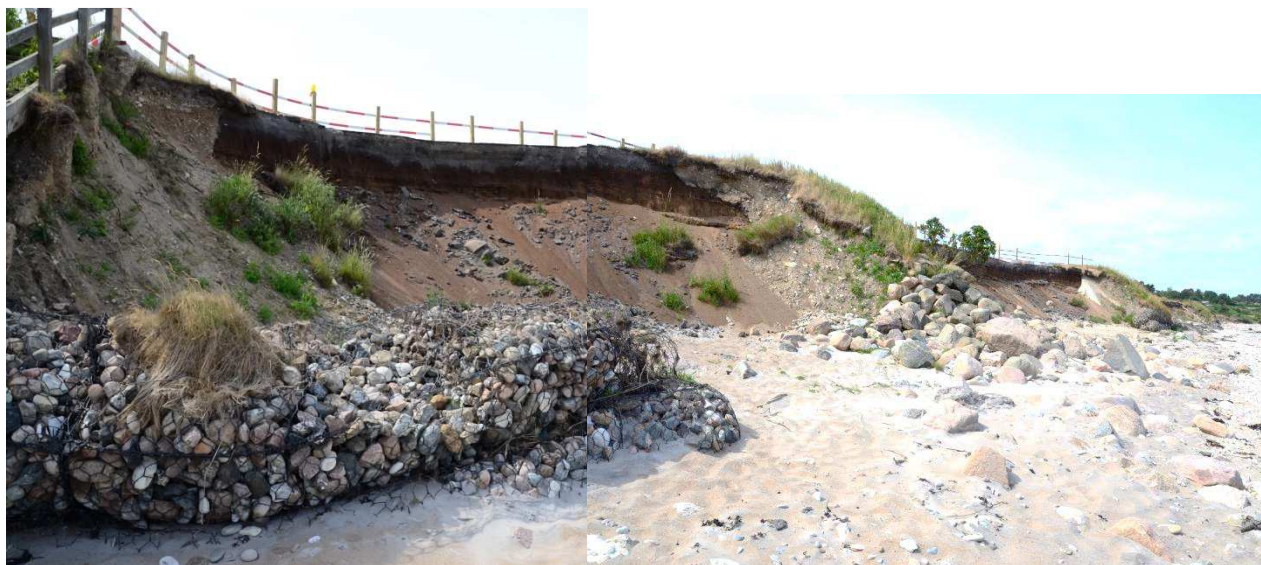
Figur 2-20 Ødelagt gabion-mur og erosion af skrænten ved Nordre Strandvej ved Lumsås
