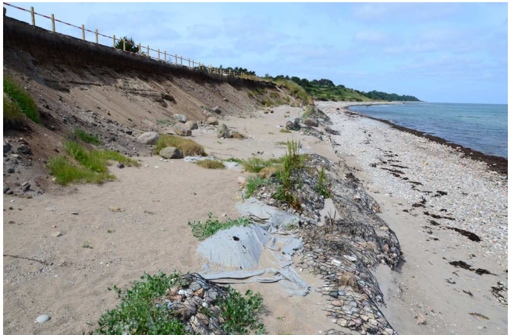
Figur 2-23 Ødelagt gabion-mur og erosion af skrænten ved Nordre Strandvej ved Lumsås
