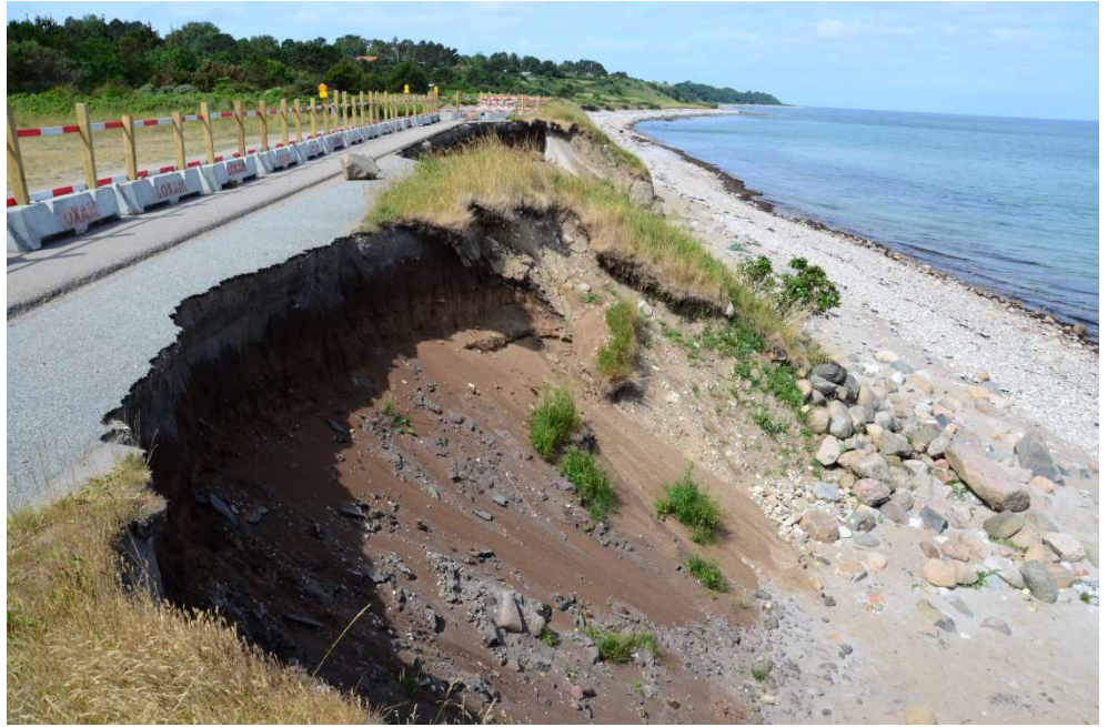
Figur 2-22 Ødelagt gabion-mur og erosion af skrænten ved Nordre Strandvej ved Lumsås
