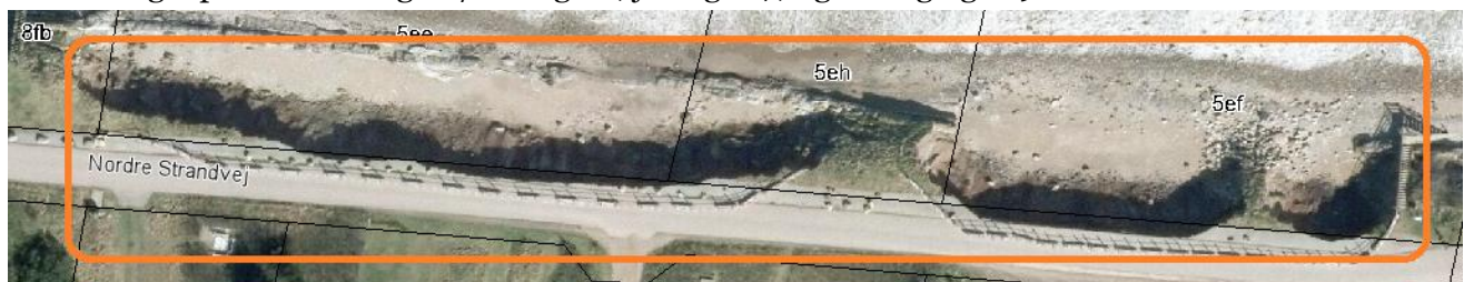
FIGUR 8 - OVERSIGTSBILEDE AF SKADERNE
