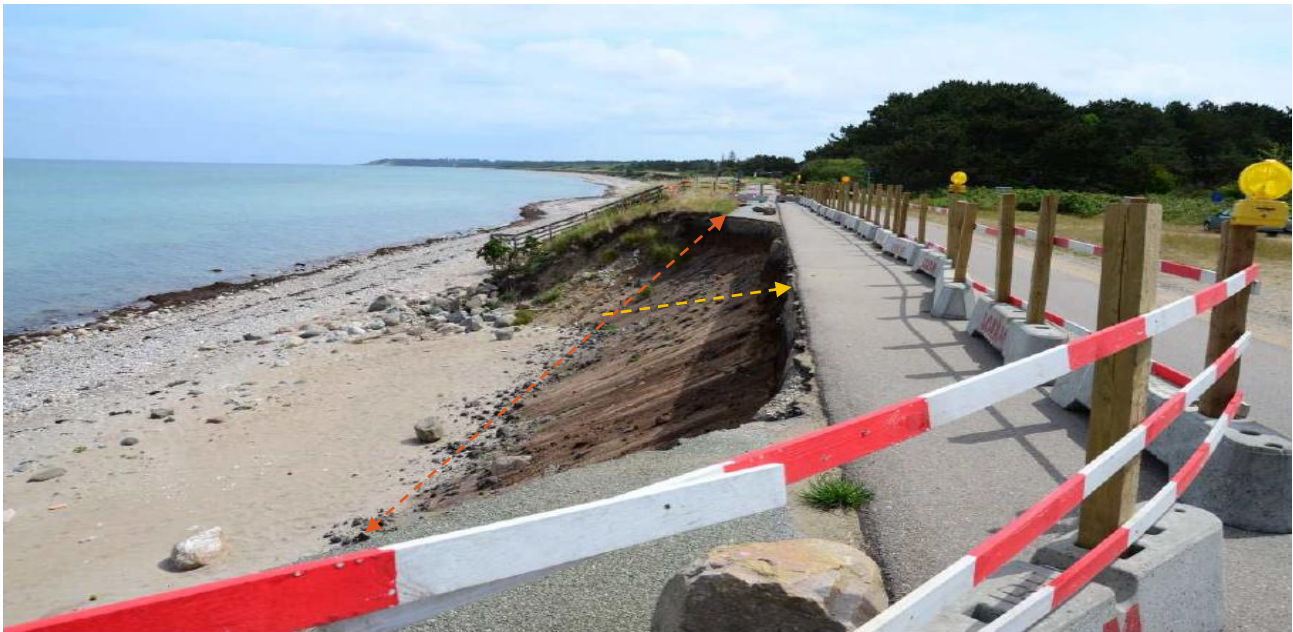
FIGUR 11 - SKADER PÅ SKRÅNING OG VEJBANE
